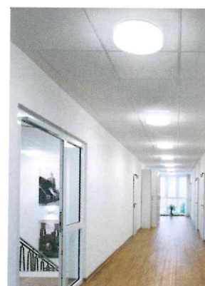
Die Deckenleuchte OBLO ermöglicht eine durchgehend gleichmäßige Ausleuchtung des Flurs.
